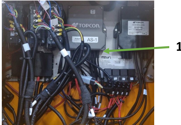
Мал. 29 Електрична шафа за кришкою панелі приладів
